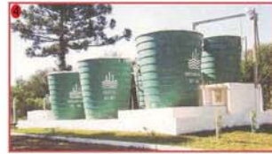
E.T.E- Estação de Tratamento de Esgoto
