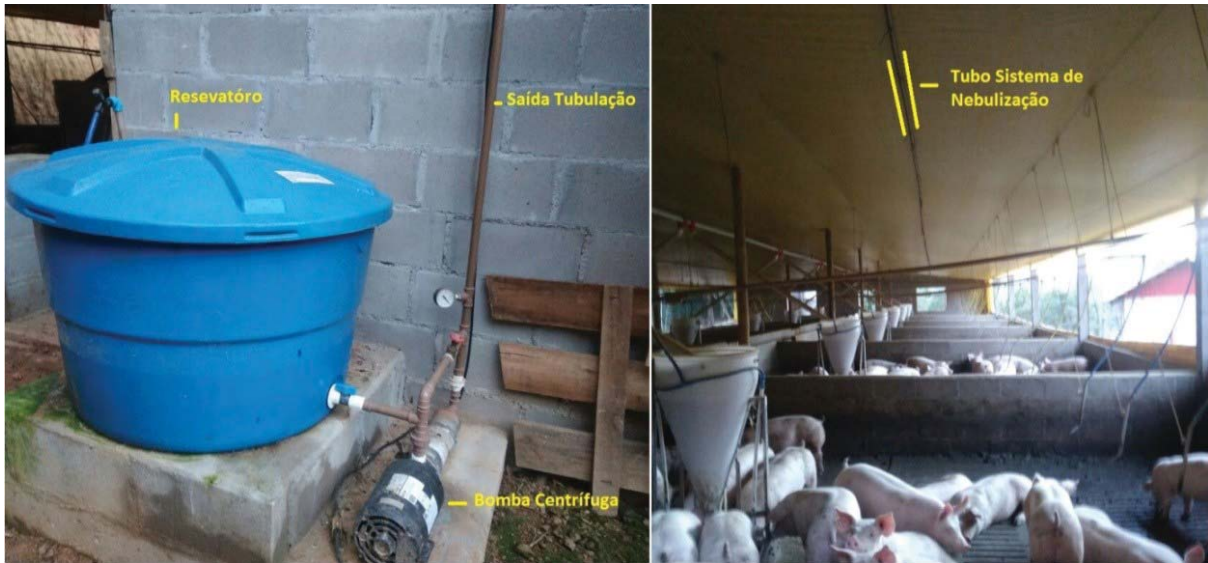
Figura 22 - Sistema de Nebulização Existente
