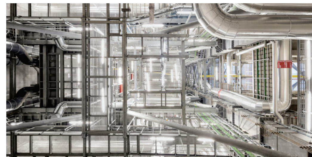
▲ A parte interna do maquinário já contruída e operante. Fonte: ARCHDAILY, 2013.
