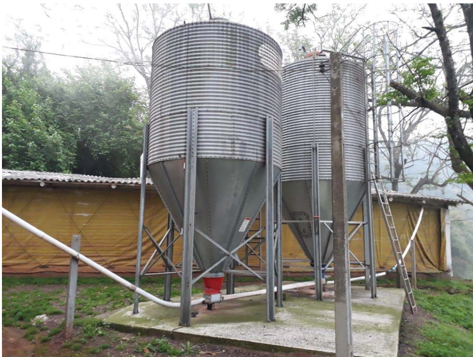
Figura 6 - Sistema de alimentação
