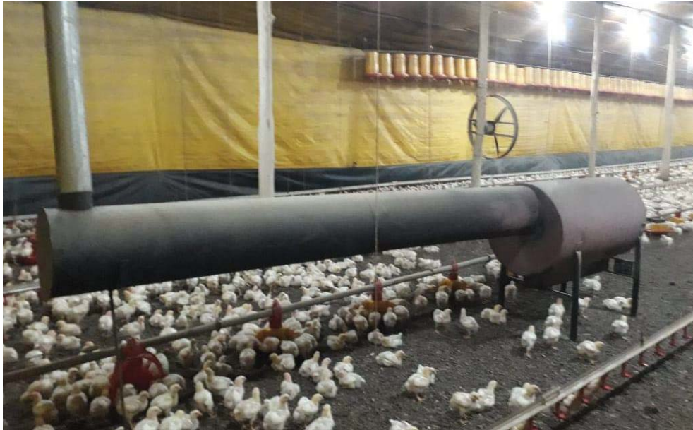
Figura 9 - Sistema de aquecimento
