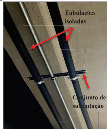
Figura 23 – Tubulações do sistema VRF
