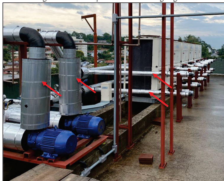
Figura 24 - Tubulações do sistema de água gelada
