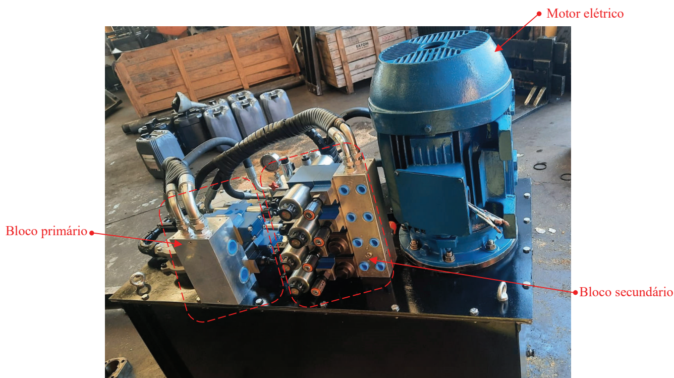
Figura 13 – Unidade hidráulica montada.
