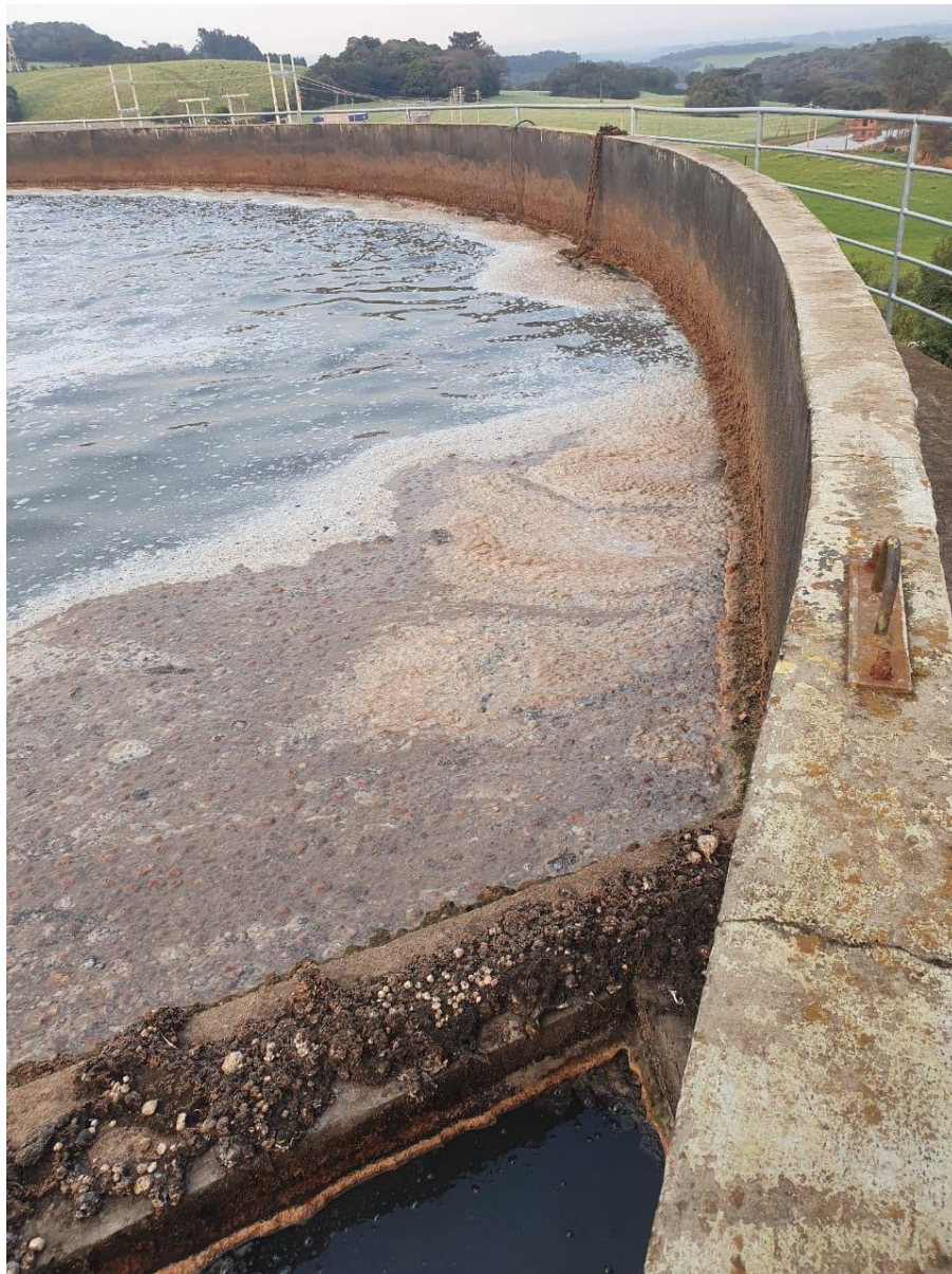
Figura 25. Tanque de acúmulo 2 com presença de efluente bruto
