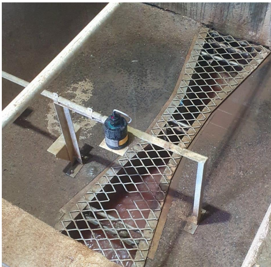
Figura 6. Medidor ultrassônicos instalado
