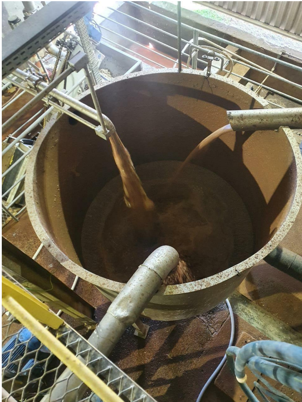
Figura 24. Tanque de acúmulo de lodo
