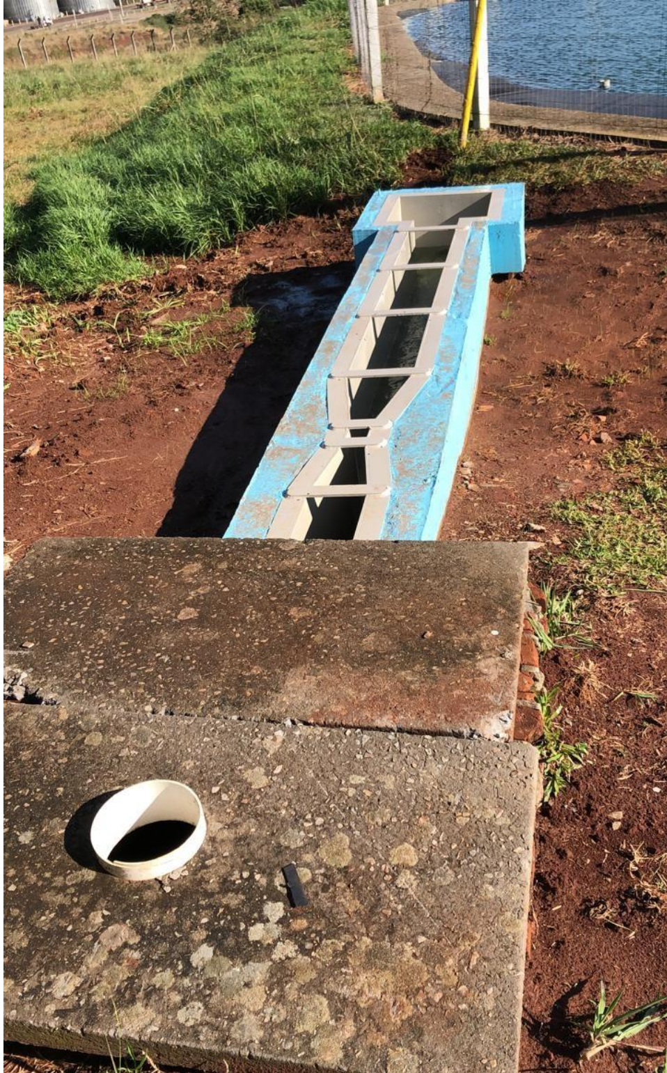
Figura 5: Local de coleta de amostra na saída da ETE do laticínio
