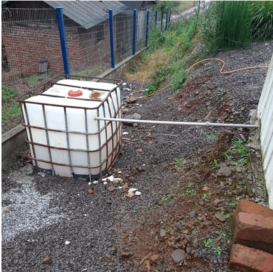
Figura 21- Local onde a água tratada fica armazenada
