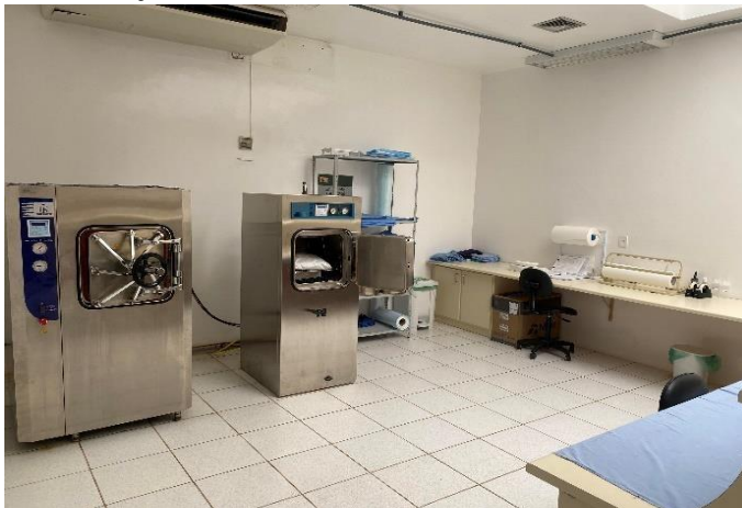
Figura 9 – Infraestrutura do Bloco Cirúrgico do HV-UPF – Área de esterilização de materiais.
