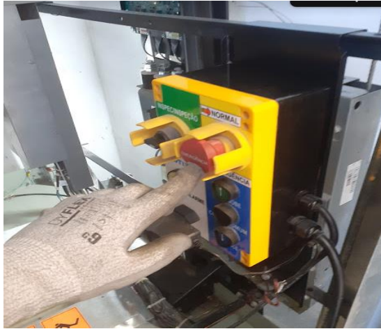
Figura 12: Pressionando o botão de emergência no topo da cabina.
