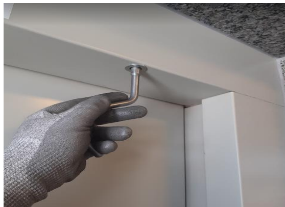
Figura 10: Destruvando o trinco da porta de pavimento.
