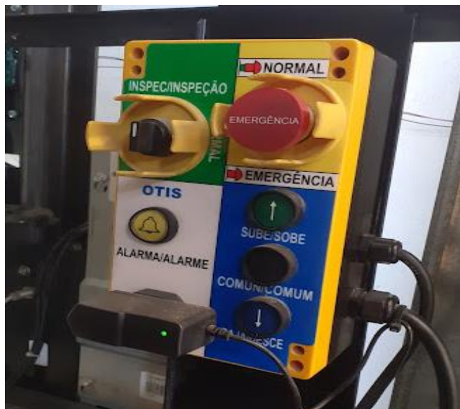
Figura 14: Caixa de inspeção de um elevador de passageiros.
