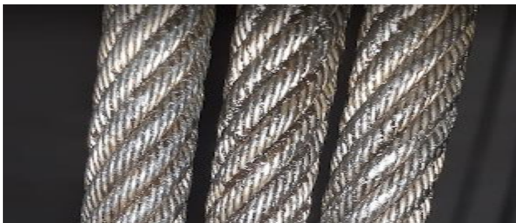
Figura 07: Exemplo de visualização dos cabos de aço no topo da cabina do elevador.
