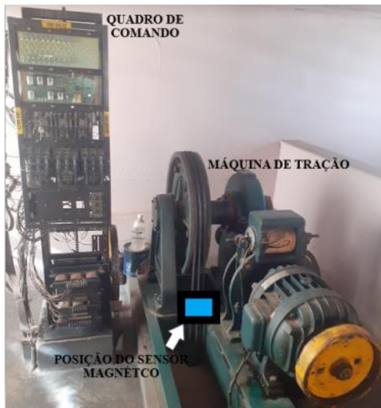
Figura 15: Demonstração de posicionamento dos sensores de VFM nos cabos de aço de um elevador.
