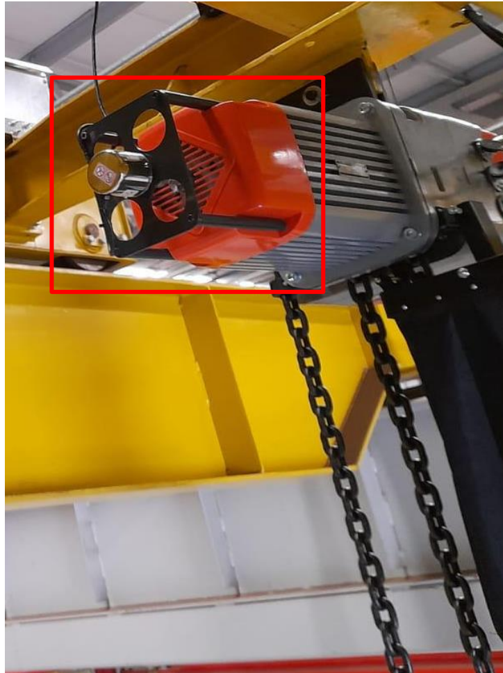
Fotografia 12 – Fixação do encoder em uma das talhas de elevação
