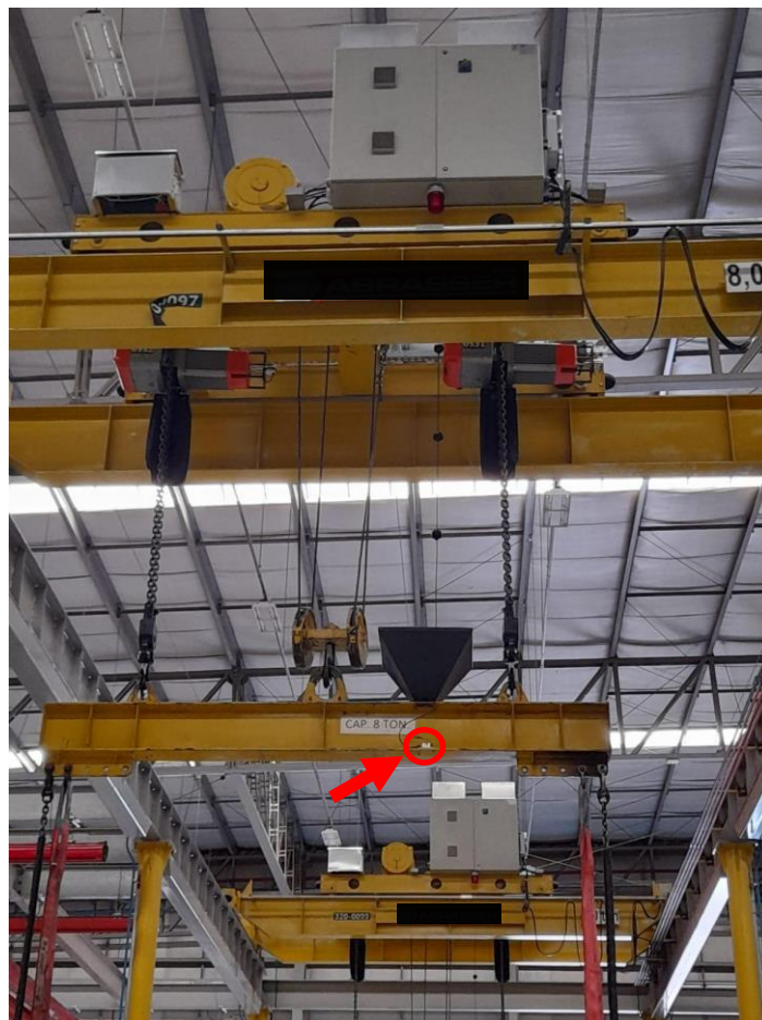
Fotografia 10 – Vista inferior da instalação do sistema de elevação
